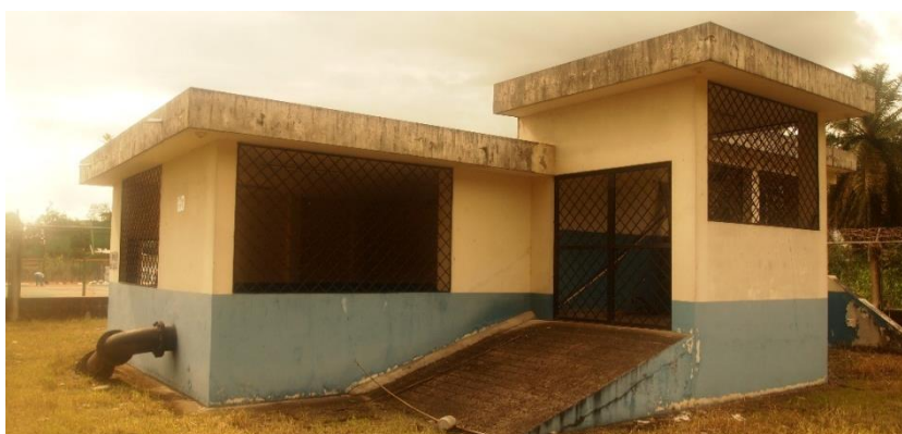
Figura 46. Estación de bombeo de aguas negras.
